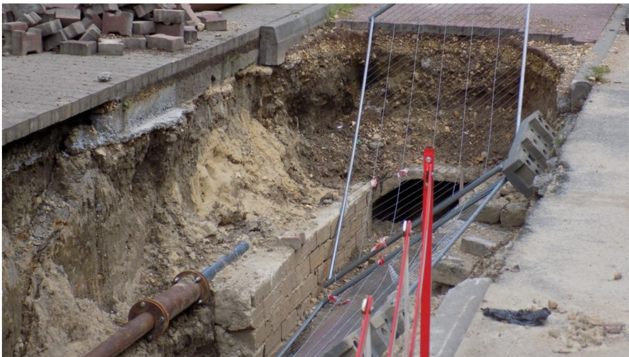
Niebezpieczny i niezabezpieczony wykop przy ul. Szeptyckiego_fot. infokatowice.eu
